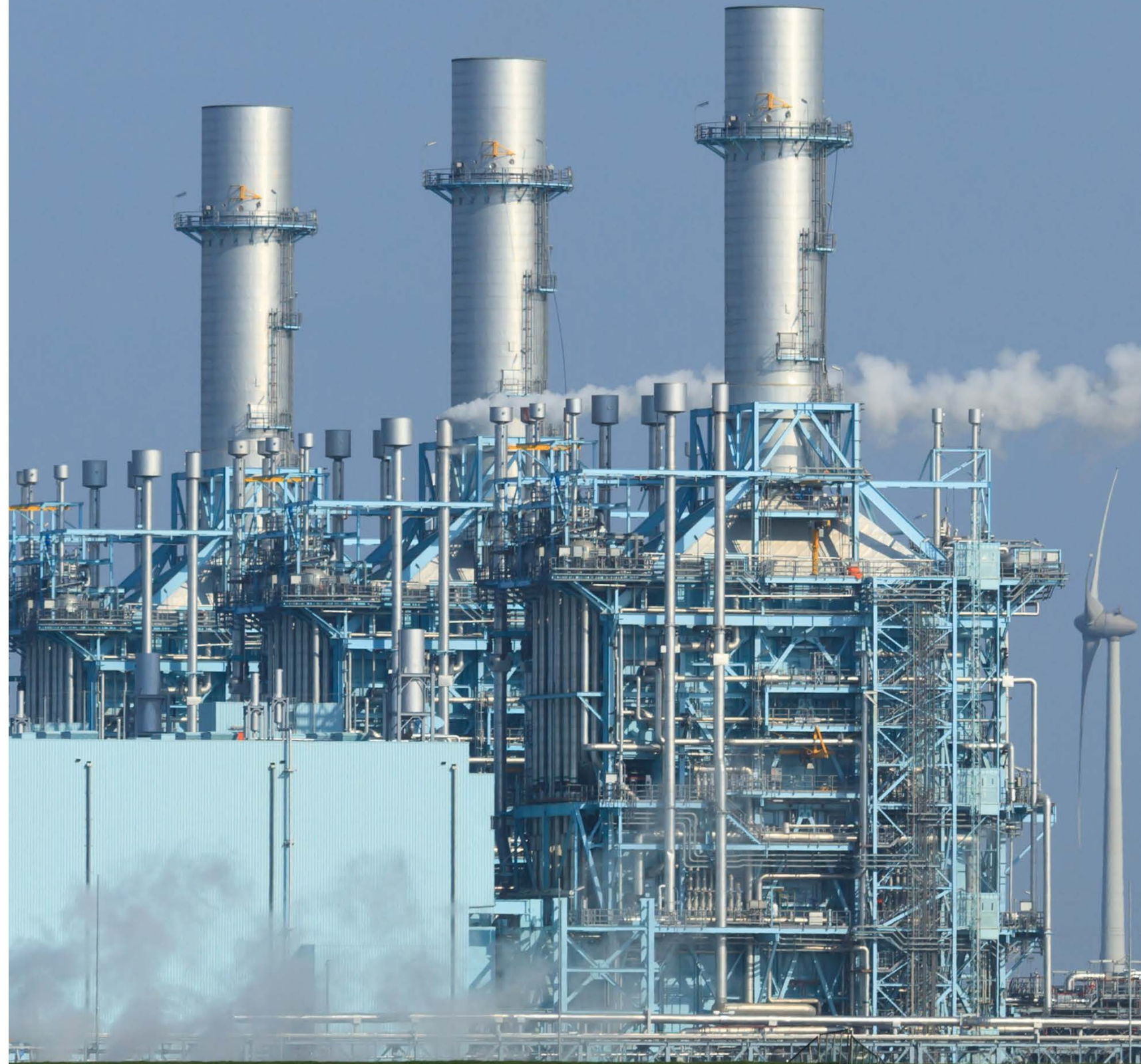
Drie multi-fuel gestookte turbines voor stroomopwekking (energieleverancier RWE) in het Eemshavengebied. Met 3 x 440 MW vermogen, kan deze installatie ruim 10 TWh vraaggestuurde elektriciteit leveren.
